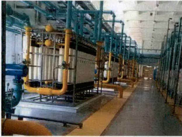
依托二期制水车间超滤装置
