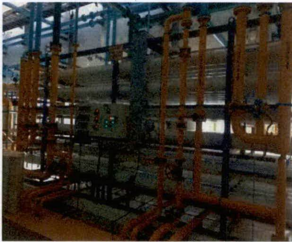
依托二期制水车间反渗透装置
